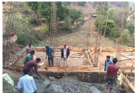
パンチャムキ・セカンダリースクールも建築が進んでいます
